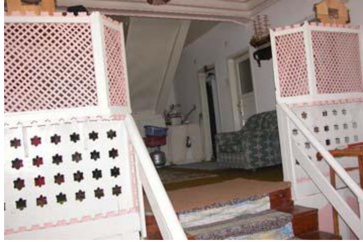
Zemin kata ıkılan merdivenler
