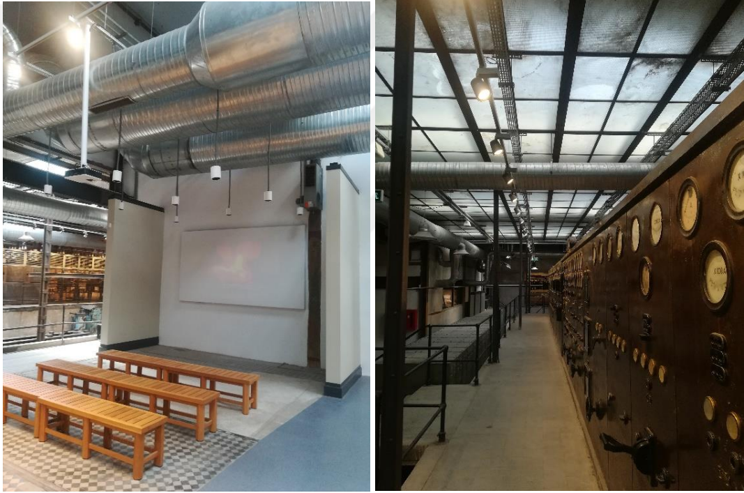
Resim 108: Müze içinden havalandırma kanallarının görüldüğü görseller. (Kaynak: Yazarın fotoğraf arşivinden alınmıştır.)
