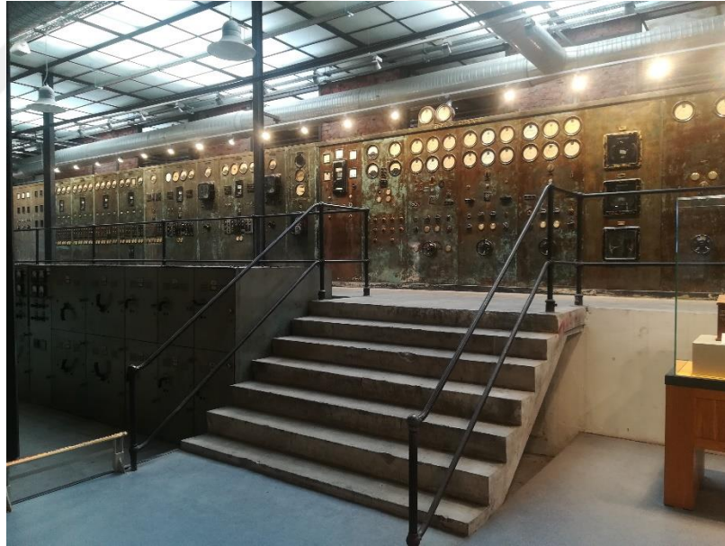
Resim 64: Elektrik kontrol panolarının müze içindeki güncel durumu. (Kaynak: Yazarın fotoğraf arşivinden alınmıştır.)
