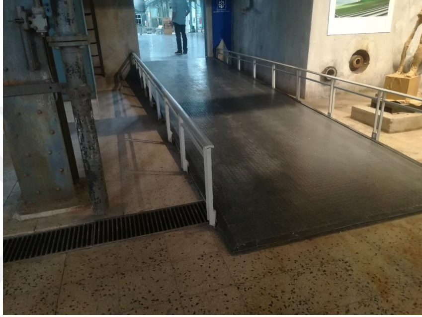
Resim 107: Kendi taşıyıcı sistemine sahip, yapıya sonradan eklenmiş bir rampa. (Kaynak: Yazarın fotoğraf arşivinden alınmıştır.)
