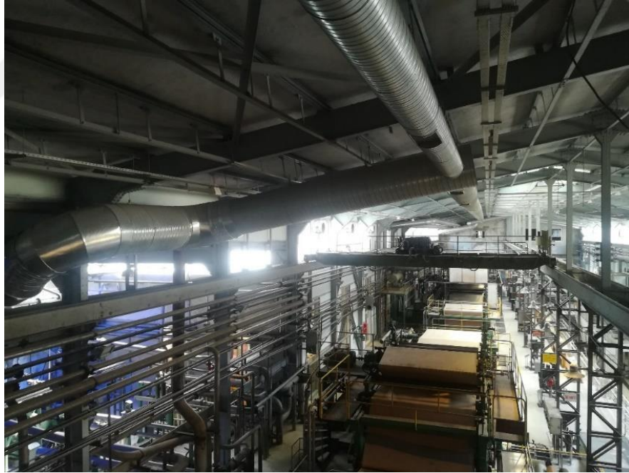
Resim 110: Müze içinden havalandırma kanallarının görüldüğü güncel bir fotoğraf. (Kaynak: Yazarın fotoğraf arşivinden alınmıştır.)
