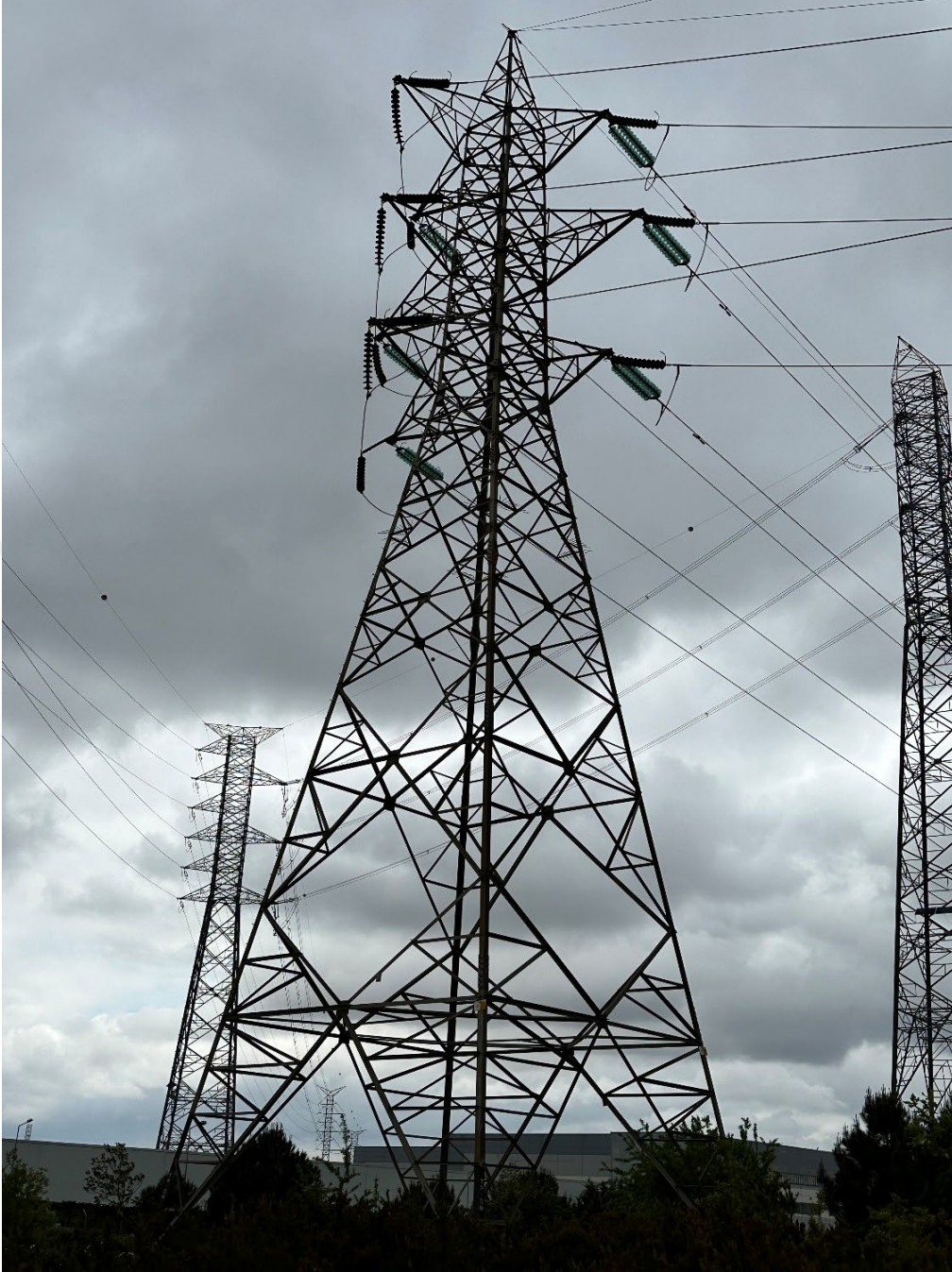
Şekil 5.24. Çalışma yapılan elektrik iletim hattının fiziksel görüntüsü
