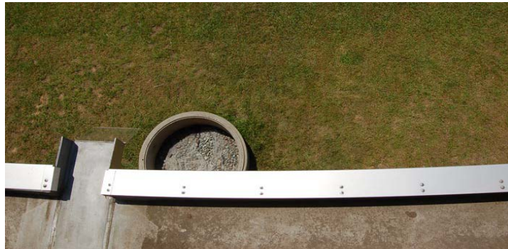
Şekil 5.9: Fuji Anaokulunda çatıdaki yağmur suyunun toplanması (http-24)
