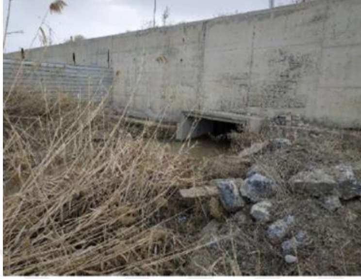
Şekil 4.2. Van Merkez1 Deresindeki Geçiş Yapısı
