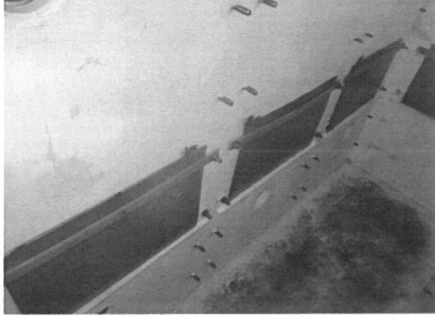
Şekil 5.1. Test-1’de Kullanılan Şönt Elemanların Kazan İçerisindeki Yerleşimi
