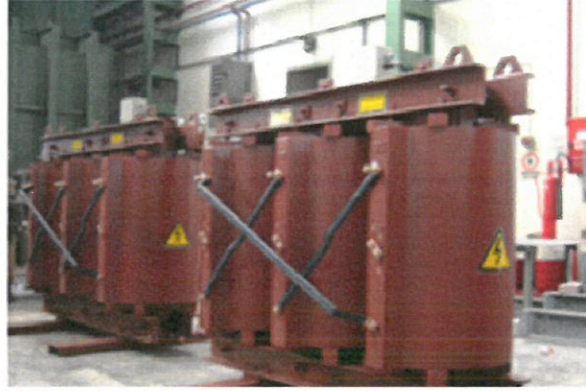
Şekil 1.7. Kuru Tip Transformatör
